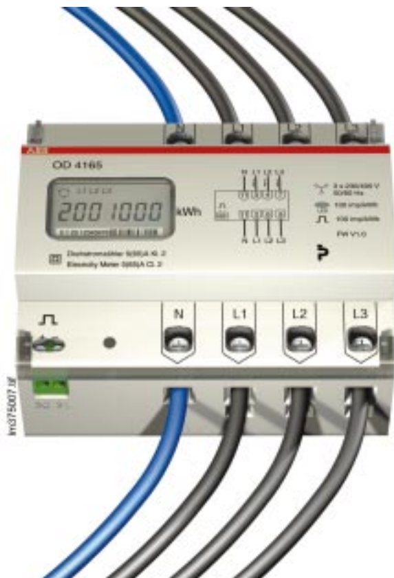
Inkoppling med kablar
